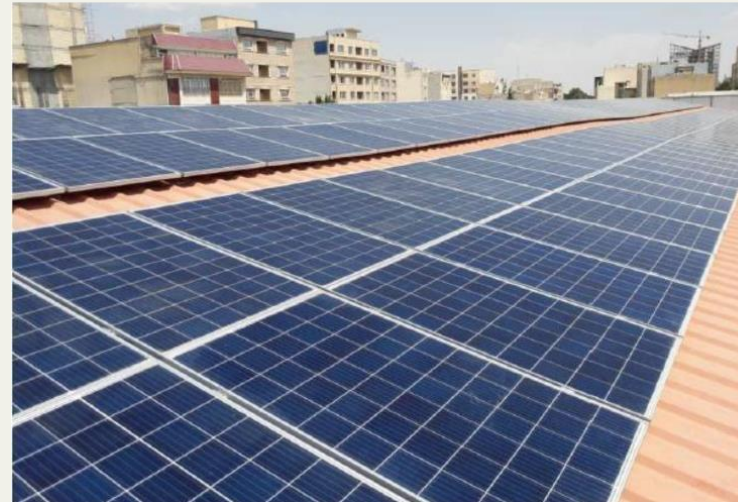
نیروگاه خورشیدی ۱۰۰ کیلوواتی استان کرمانشاه سال احداث: ۱۳۹۷
